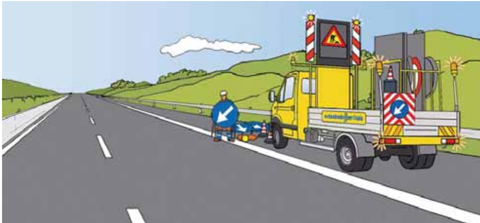
Figura 31 – Chiusura della corsia di marcia: scarico ed inizio installazione della segnaletica di esclusione della corsia
